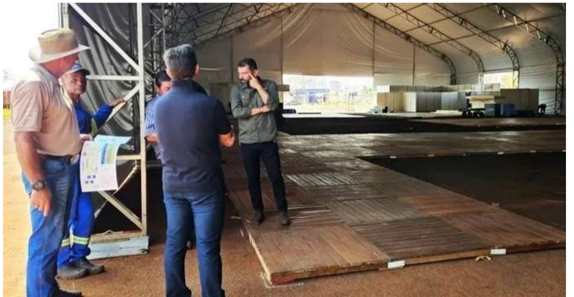
Trabalhadores no estacionamento do Teatro Lauro Martins fazendo a montagem dos estandes para a realização da Sudoexpo 2024 — Foto: Reprodução.
